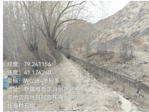
破损灌渠现状
