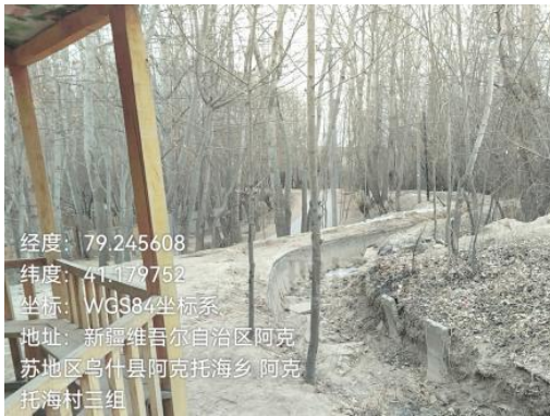
破损灌渠现状
