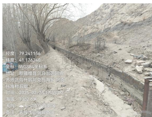
破损灌渠现状
