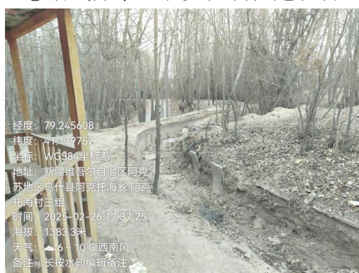
破损灌渠现状
