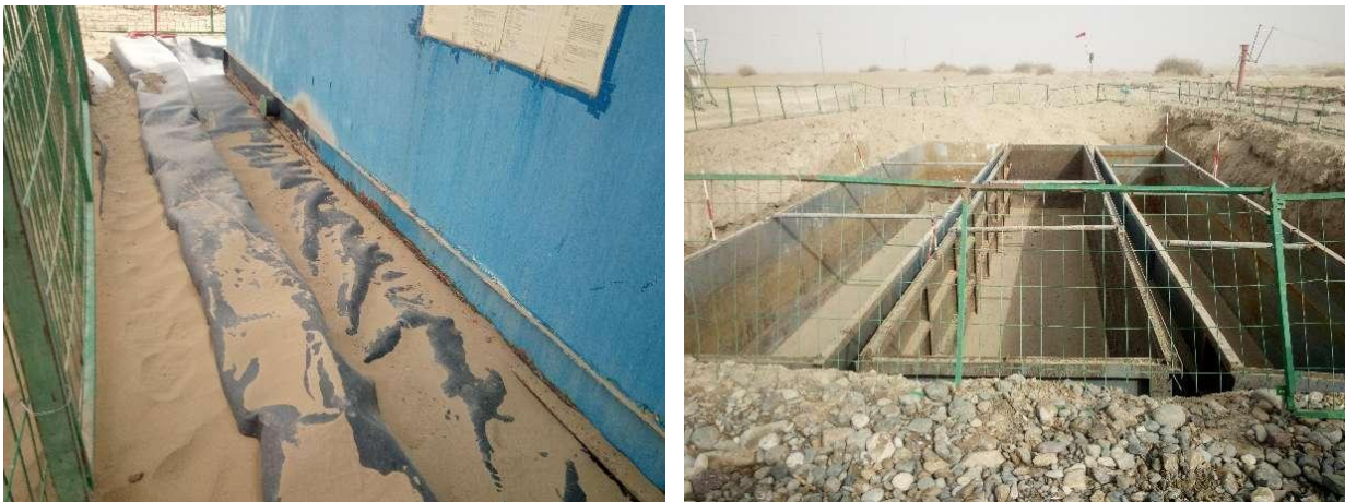
图 3.2-1 钻井期间设备底部防渗膜和钢板应急池
